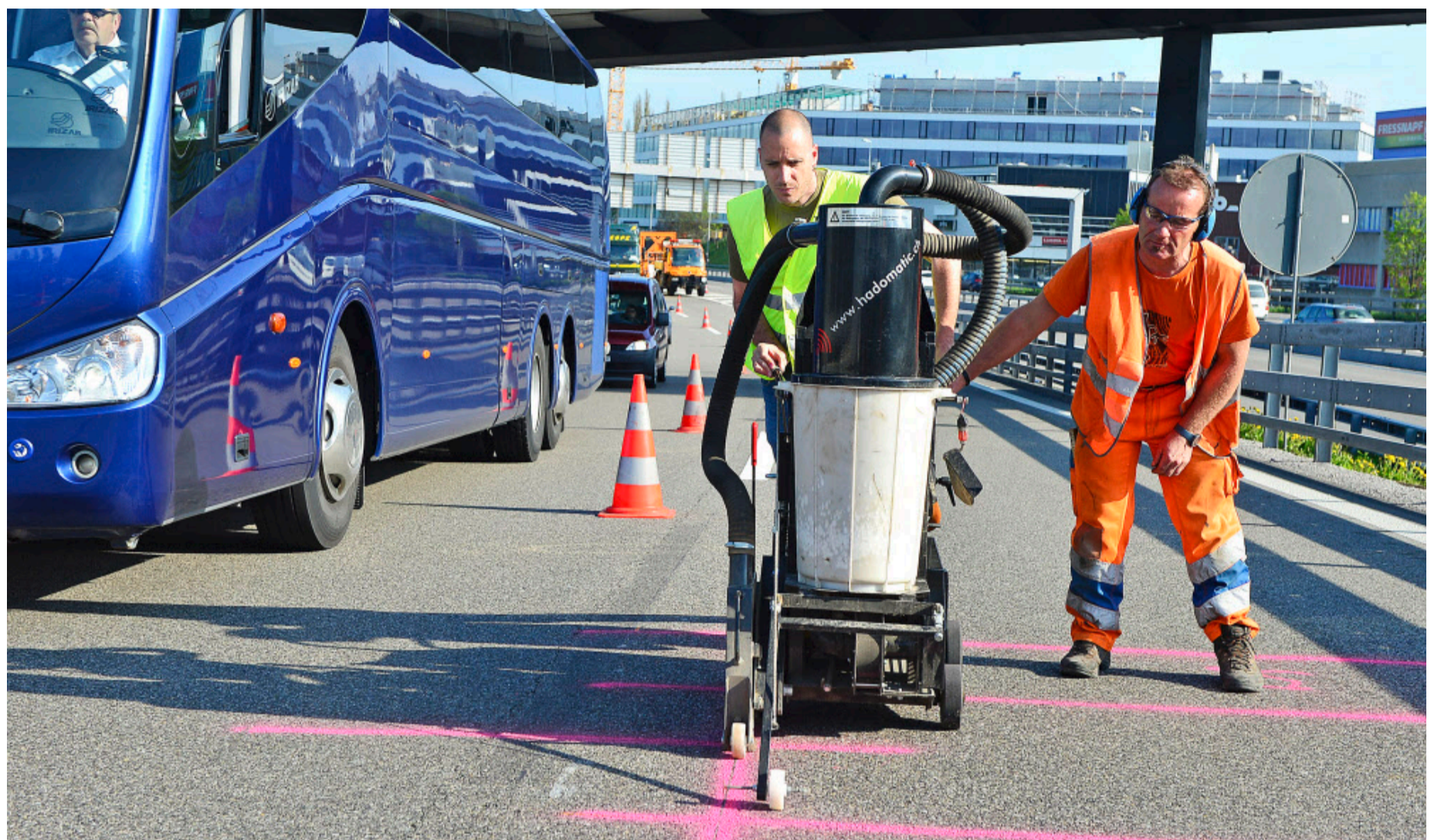
TT-Redaktor Marco Zysset fräst unter Anleitung von Niklaus Bigler einen Schlitz in den Asphalt der Normalspur auf der A1 bei der Verzweigung Wankdorf. Auf der Überholspur rollt derweil der Verkehr weiter.
